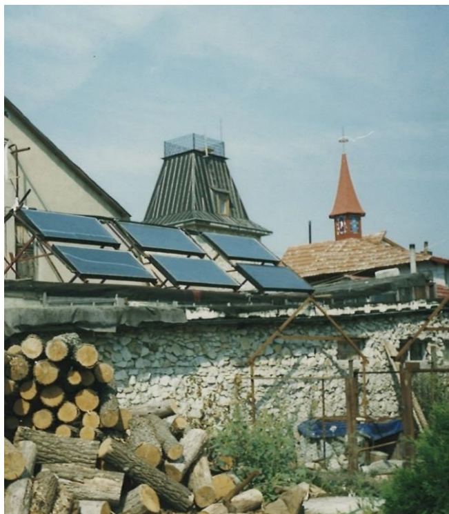
Рис.1. Внешний вид установленных гелиоколлекторов
