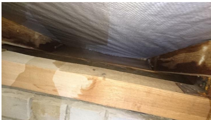
Рис. 2. Образование наледи на наружных ограждающих конструкциях
