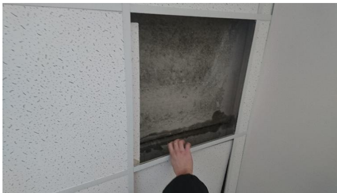
Рис. 4. Протечка между плитами чердачного перекрытия
