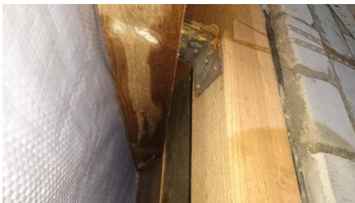
Рис. 3. Следы увлажнения и стекания влаги, образовавшейся при конденсации на внутренней поверхности ограждающих конструкций
