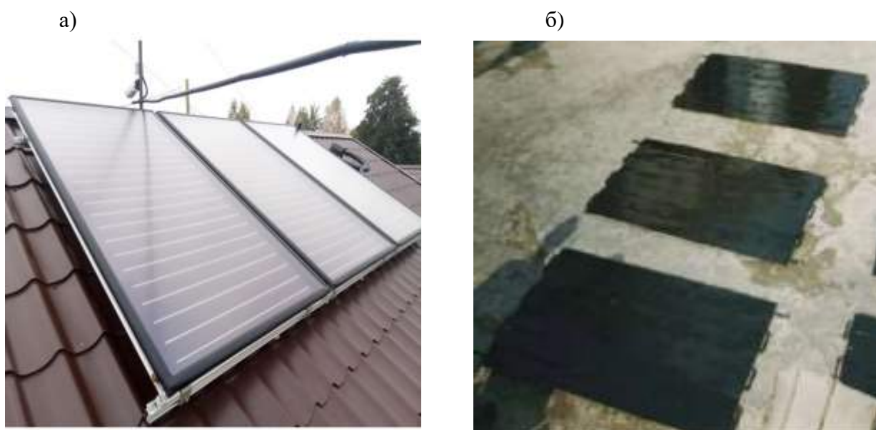
Рис. 2. Солнечная установка горячего водоснабжения производителя: а – Huch Entec; б – аналог установки в исполнении подрядчика
