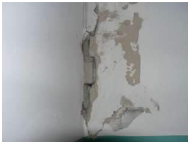
Рис. 5. Вертикальная трещина в стенах лестничной клетки на верхних этажах жилого дома № 10 по ул. Кирова в г. Воронеже
