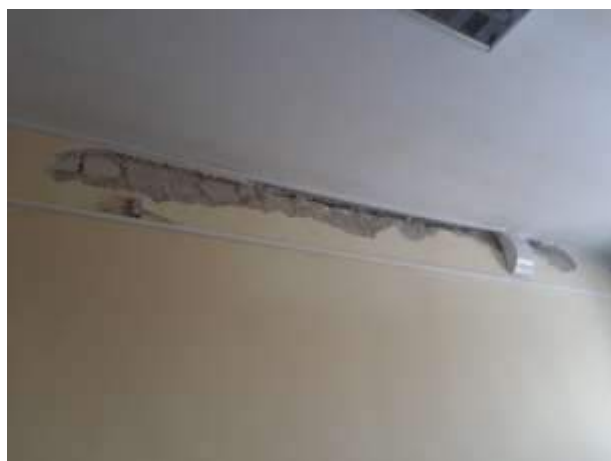
Рис. 3. Трещина на стыке плит перекрытия и внутренней поперечной стены детского сада № 99 по пер. Павловский, д. 58 в г. Воронеже
