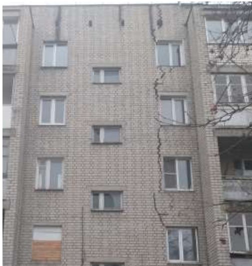
Рис. 4. Вертикальная трещина по фасаду жилого дома № 4 в г. Борисоглебск, ул. Чкалова, Воронежская область
