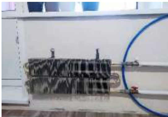
Рис. 2. Неправильная эксплуатация конвектора – снят кожух
