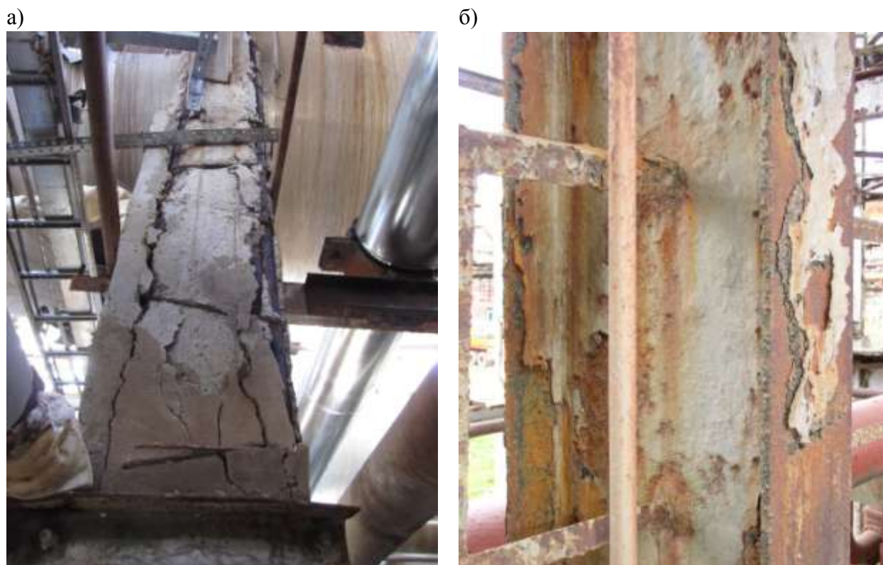
Рис. 1. Повреждения строительных конструкций, вызванные коррозией, вследствие отсутствия защитных покрытий и регулярных капитальных ремонтов: а – железобетонные конструкции; б – стальные конструкции
