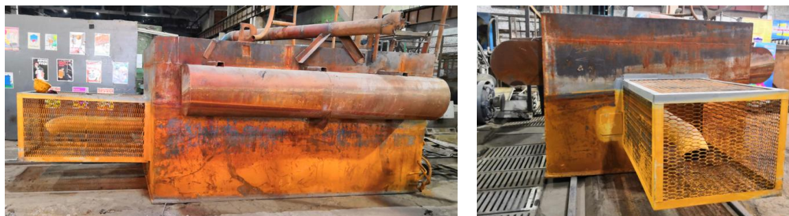
Рис. 5. Внешний вид решетки (фильтра) на понтоне на входе в насос
